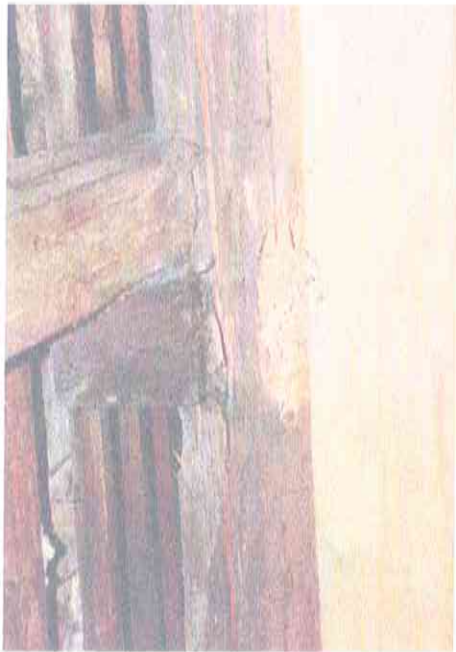
Fot. nr 2 Wypróchnienie ugiętej płatwi w lukarnie północno-zachodniej.
