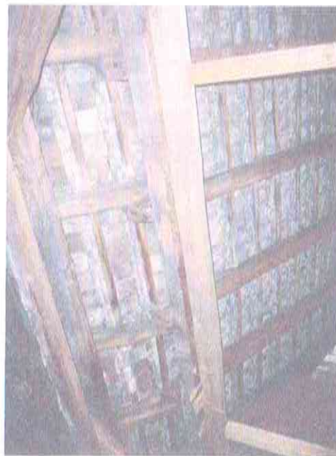
Fot. nr 1. Ugięcie i podparcie płatwi w lukarnie północno-zachodniej.
