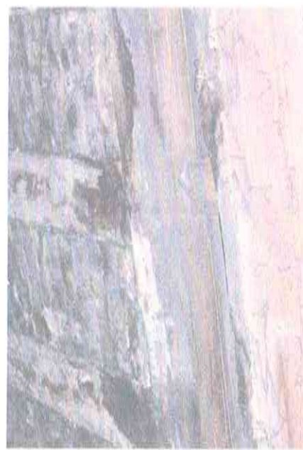
Fot.7 Zniszczona długotrwałym działaniem wilgoci konstrukcja pienowych słupów i podwaliny.
