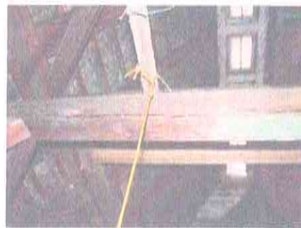
Fot. 3,4 Uszkodzony słup podpierający płatwę w lukarnie północno-zachodniej.
