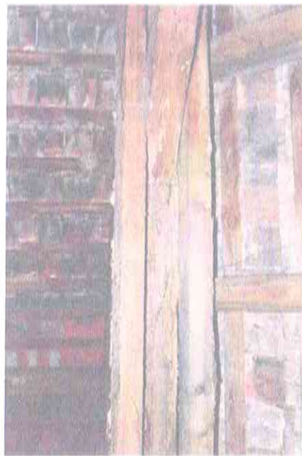
Fot.8 Uszkodzenia płatwi pod murem pruskim w północno-zachodnim szczytzie.
